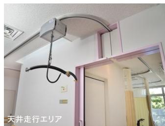
天井走行エリア
